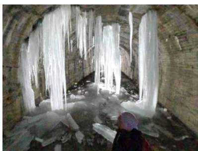
ニツ小屋隧道内部では、巨大な氷柱がみられます
